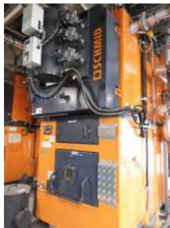
図 3-32 導入ボイラー
