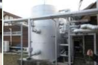
蓄熱タンク（7,000ℓ 2基）
