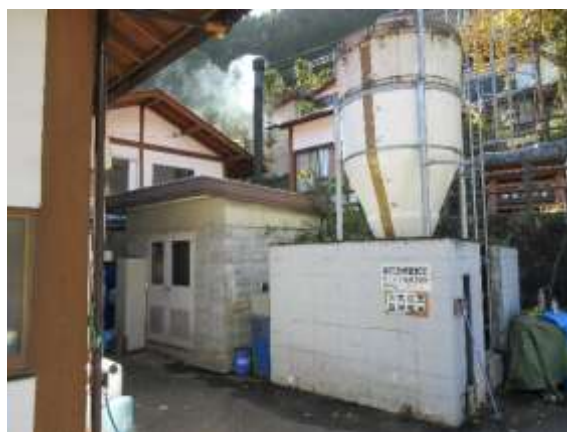
図 3-52 ボイラー室・貯蓄タンク
