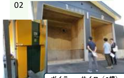
ボイラー、サイロ（2槽）
