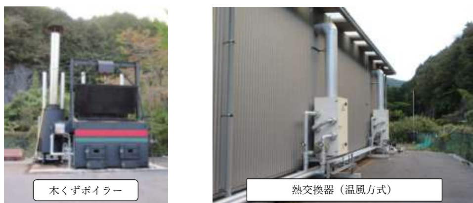
図 3-60 ボイラーおよび付帯設備
