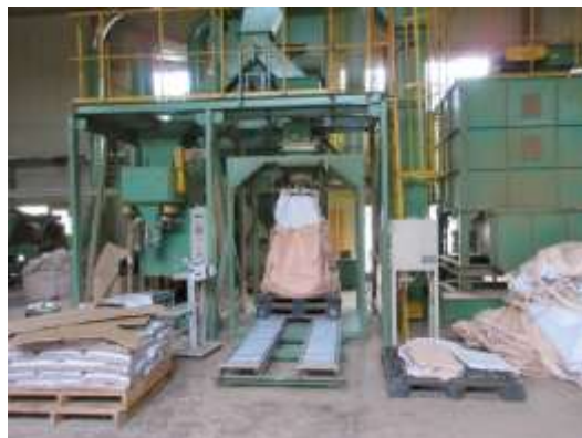
図 3-55 ペレット製造施設
