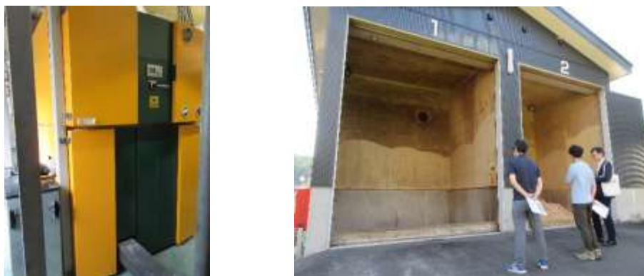
図 3-41 チップボイラーおよび付帯設備
