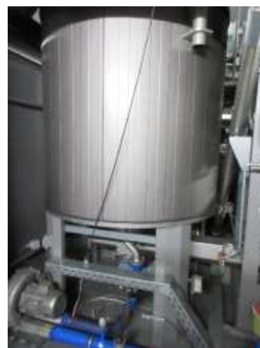
図 3-54 熱電併給施設（ガス化炉）
