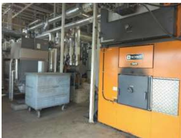
図 3-37 設置されたボイラー
