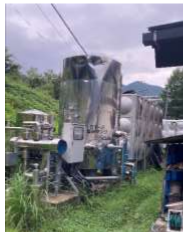
図 3-53 高温のお湯を貯める蓄熱タンク
