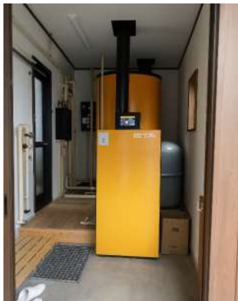
図 3-34 製材行為事務所に設置のボイラー
