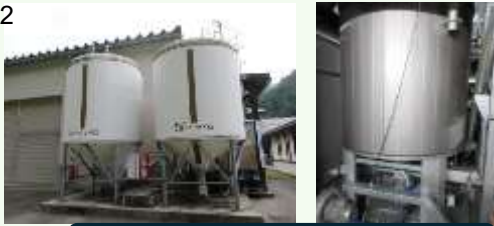
熱電併給施設（サイロ、ガス化炉）
