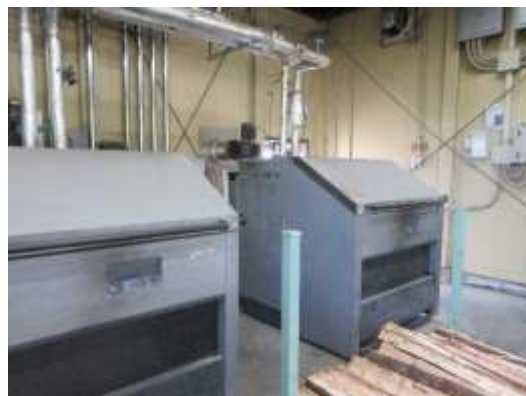
図 3-47 薪ボイラー(2基設置)
