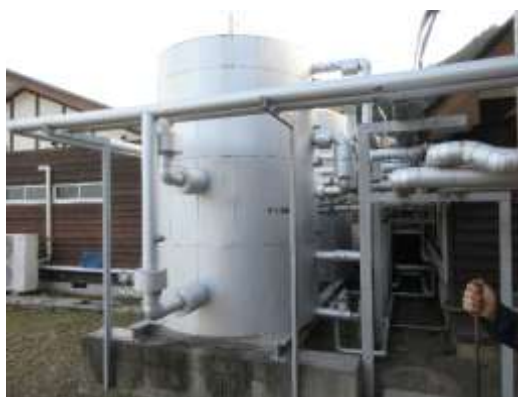
図 3-49 高性能蓄熱タンク
