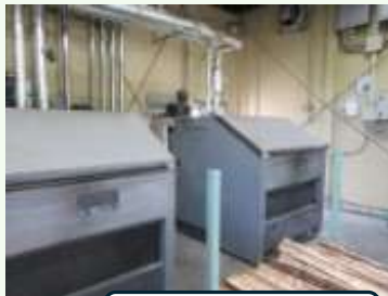
薪ボイラー屋内 (2基設置)
