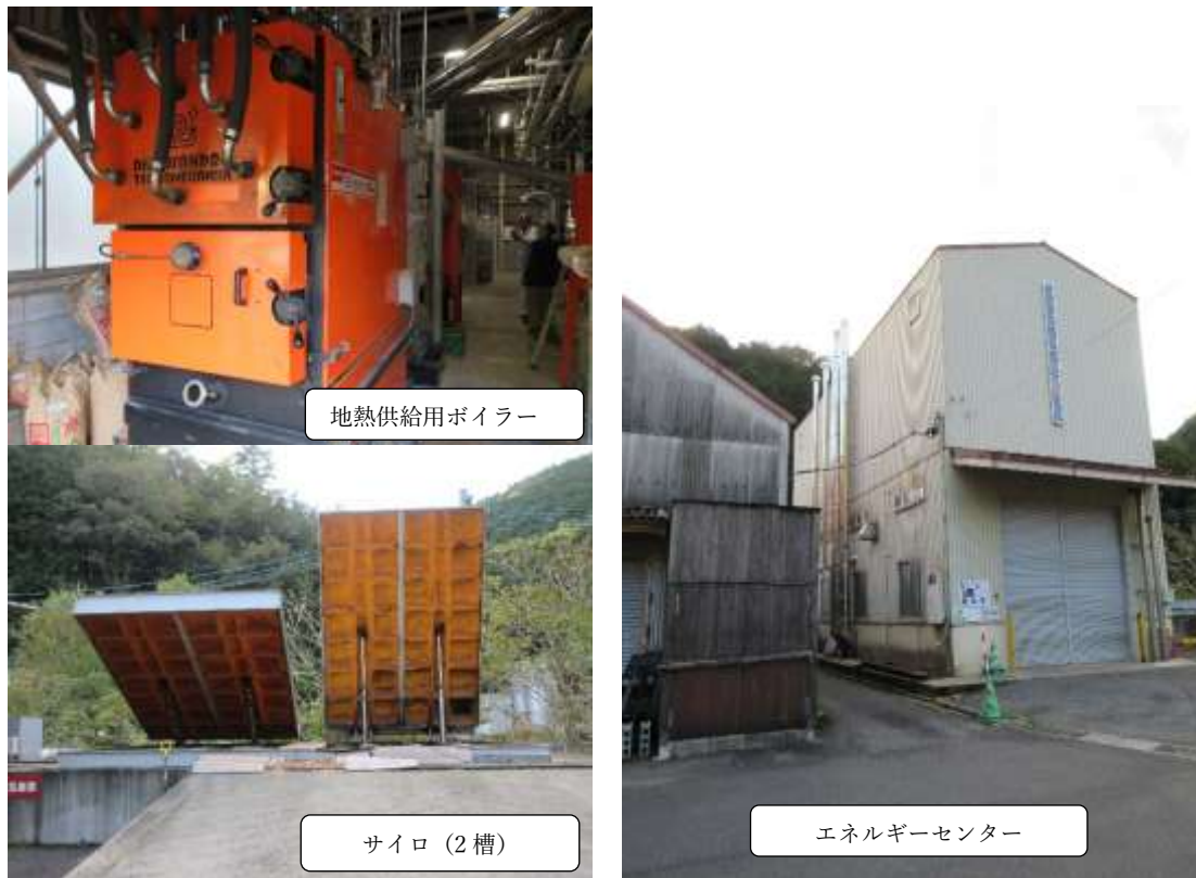
図 3-59 チップボイラーおよび周辺設備
