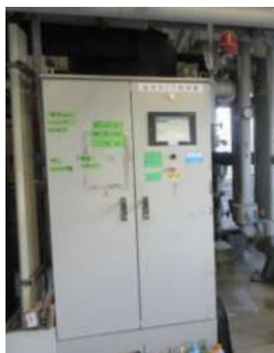
図 3-66 温水ボイラー制御盤
