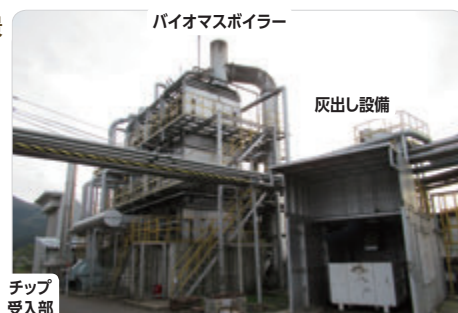
● バイオマスプラント全景
