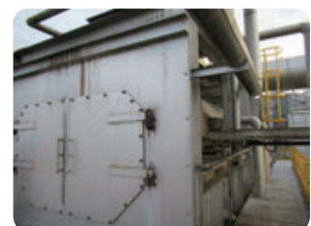
● バイオマスボイラー
