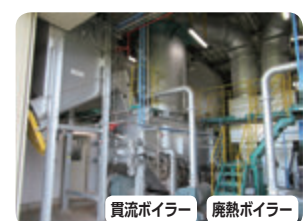
貫流ボイラー 廃熱ボイラー
