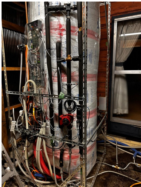
外装内部のタンク断熱状況 32Kグラスウール100mm保温
