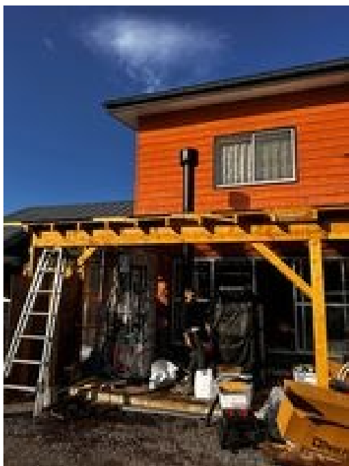
薪ボイラー設置状況
