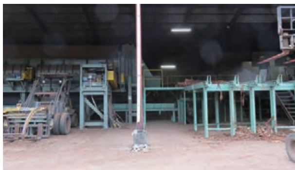
県内に3か所工場を保有しており、エネルギー用だけでなく製紙用のチップも生産しています。写真は固定式のチッパーです。
