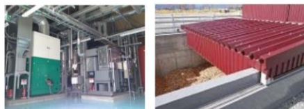
地下式 -チップボイラー -チップサイロ
